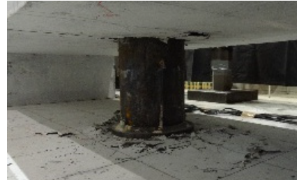
写真-2 支圧破壊状況 (SB-1)
