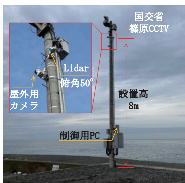
図-2 現地観測機器設置状況
