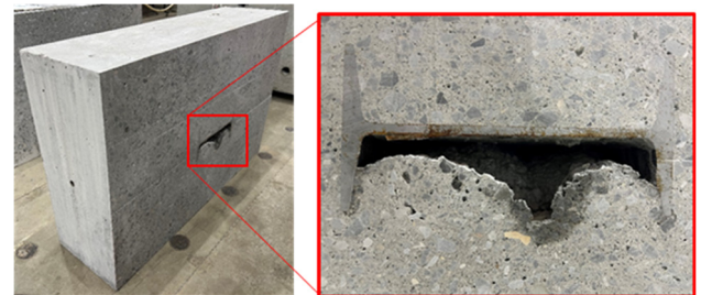
写真-2 孔なし試験体の切断面
