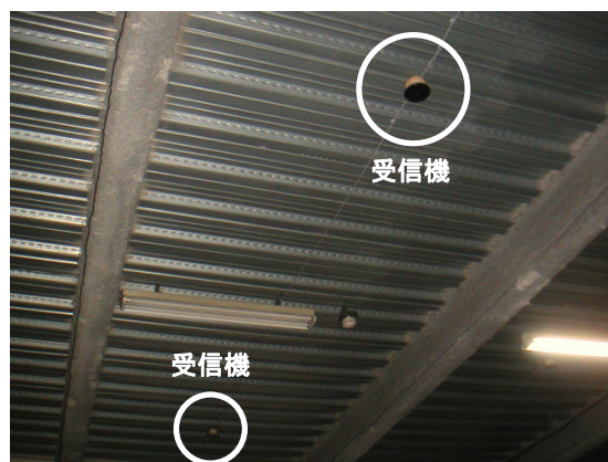
写真1 受信機 設置状況
